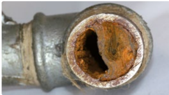
Tuyau présentant des dépôts de calcaire
