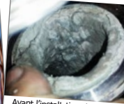
Avant l'installation de Vulcan : Le tuyau était recouvert de dépôts de calcaire.
