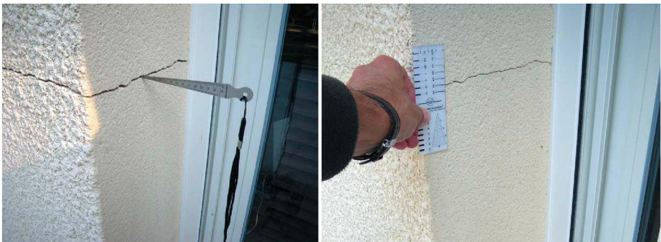
Figure 3 : Une même fissure, ouverte de 2 mm en fin d'été et de 0,5 mm en fin d'hiver, source Ifsttar
