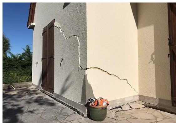
Maison fissurée par la sécheresse - Crédit photo : L. Ighil Ameur © Cerema.
